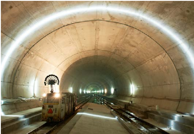
스위스 열차 터널 내부에서 작동 중인 tCrack 시스템
